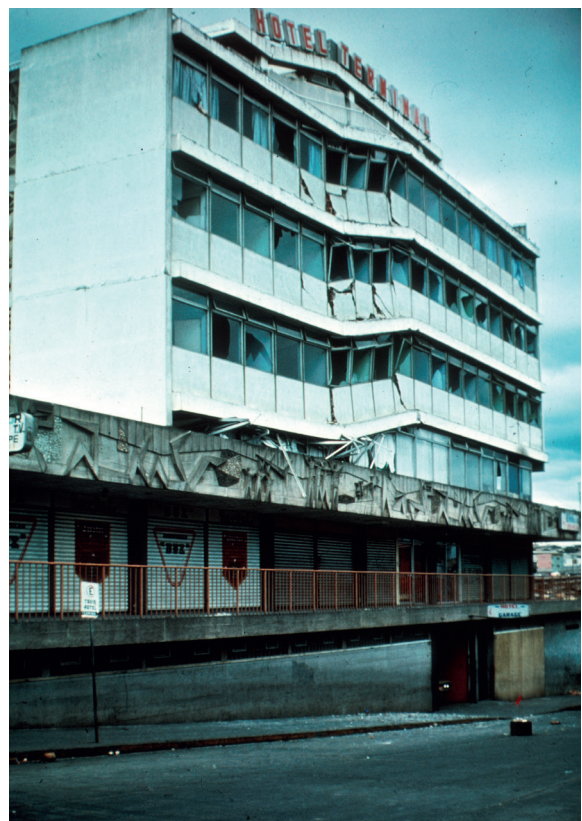
Daños a edificio ubicado en la ciudad de Guatemala Crédito fotográfico: USGS
