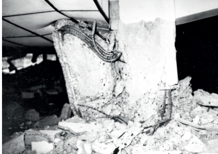
Daños estructurales en edificio ubicado en la ciudad de Guatemala
